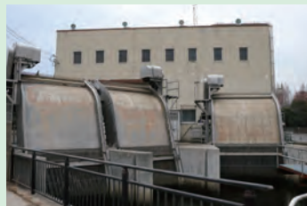
旭排水機場 (相生市旭)
