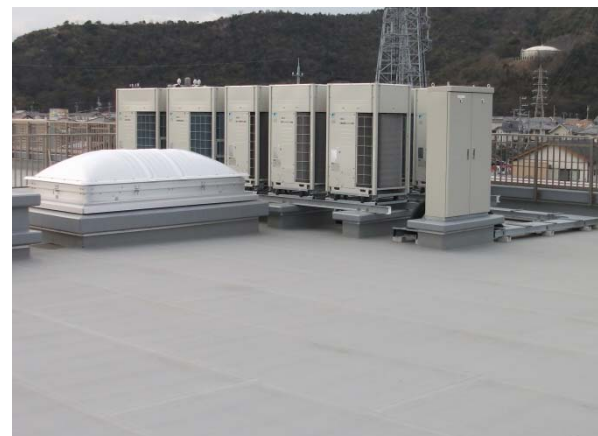
空調施設(屋上)
