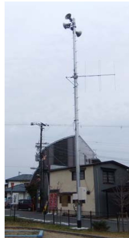
相生市施工子局装置
