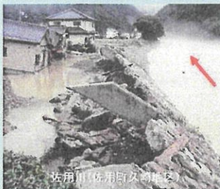
佐用川の洪水痕跡と被災状況 (H21年)
