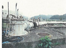
竹万救急内水排水機場 主ポンプ設備(16年経過)
