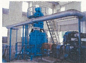
1号主ポンプ設備 (11年経過)
