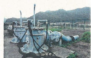
久崎救急内水排水機場 主ポンプ設備(17年経過)
