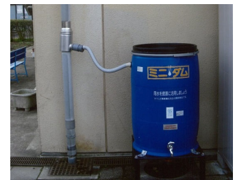
雨水貯留タンク
