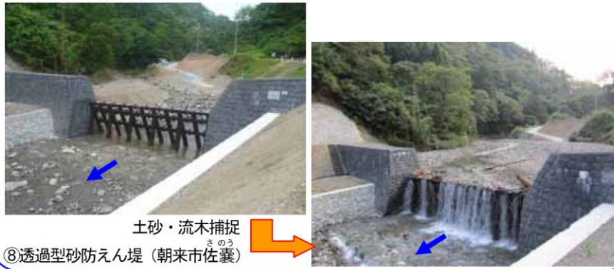
図 5.6.7 朝来市の神子畑川における砂防堰堤による土砂の捕捉状況 (2011 (平成 23) 年 9 月豪雨時)
