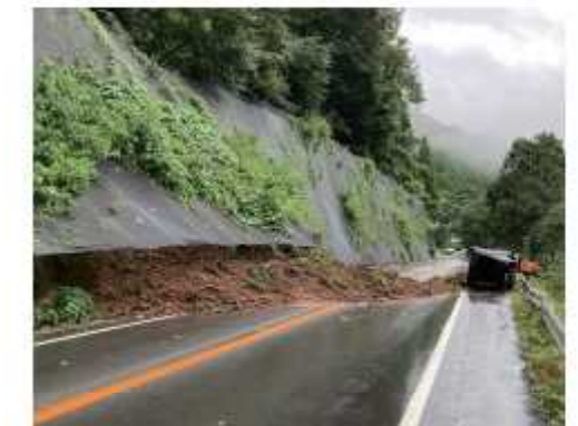
(国)178号台風豪雨による土砂崩れ状況 令和5年8月(豊岡市竹野町河内)
