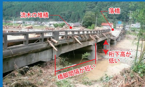
平成 21 年台風 9 号 (H21.8) 円山川 朝来市新井 市道 新橋
