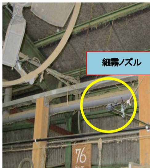
写真4 換気扇と細霧ノズルの組み合わせ
