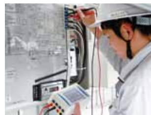
専用計測器による点検
