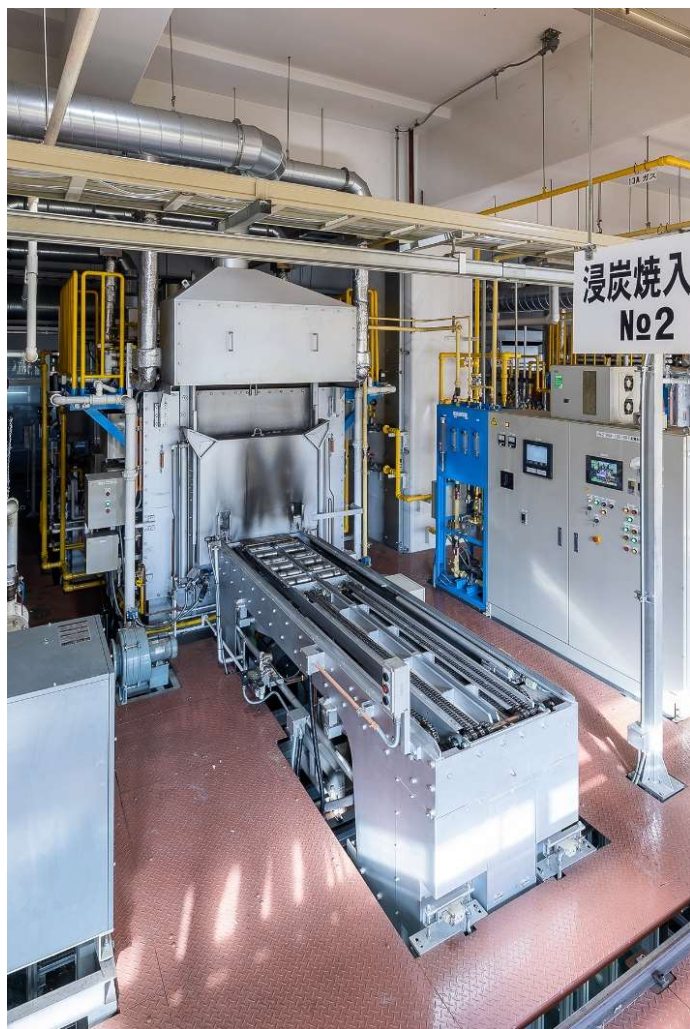
「熱処理炉」を導入、2基が稼働
