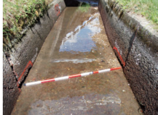
水路の側壁の粗骨材剥落及び 底盤のひび割れ点検確認
