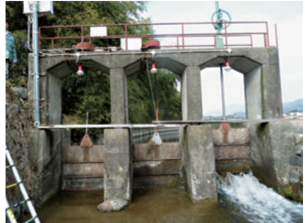
鋼製ゲートの腐食が進行し、操作が 困難
