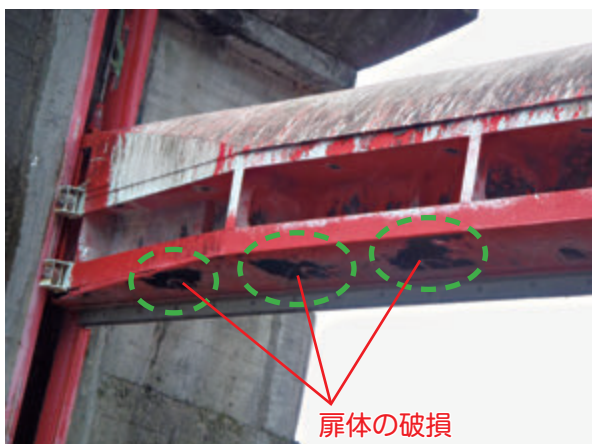
頭首工（鋼製）の塗装劣化、腐食に より扉体の底部が一部破損
