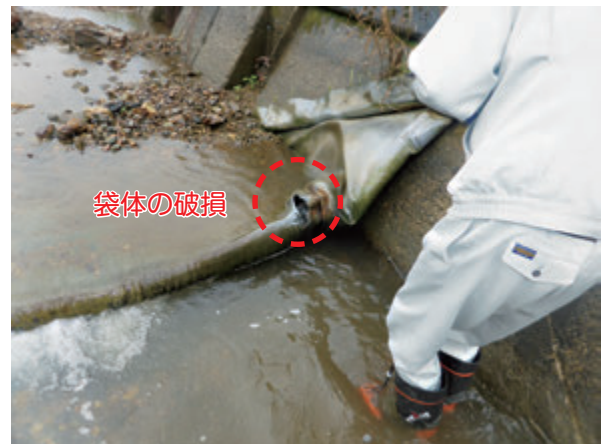
頭首工（ゴム堰）の袋体の磨耗によ り一部が破損
