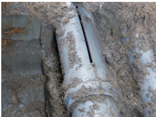
パイプラインの破裂
