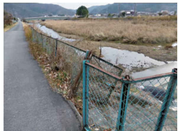
安全施設（転落防止柵）の破損
