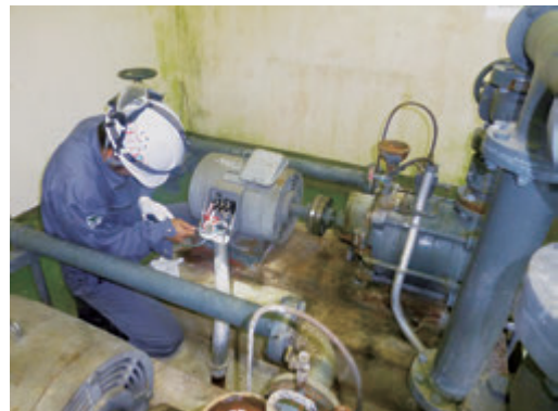
用水ポンプの絶縁診断
