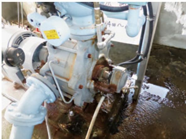
ポンプのパッキン劣化による水漏れ
