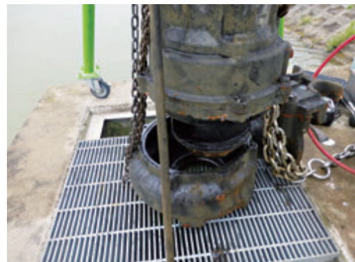
水中ポンプの故障
