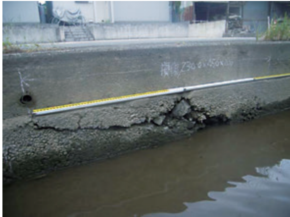
コンクリート水路の摩耗により、 骨材が露出、壁の一部が破損
