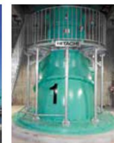
排水ポンプ(口径 2,200mm)
