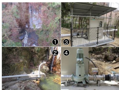
小水力発電所（神戸市灘区六甲川）
