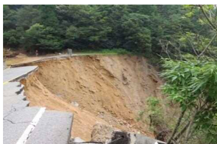
道路の崩落状況 (神戸市北区有馬町)
