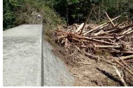
砂防ダムに堆積した流木 (神戸市北区有野町 六甲砂防事務所撮影)
