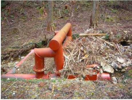
平成 23 年台風 12 号で発生した 流木と土石の捕捉状況（多可町加美区的場）
