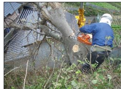
人家裏の危険木伐採
