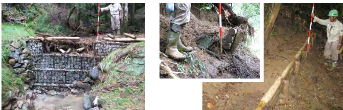
〔写真Ⅲ-2-9〕簡易防災施設の効果(左：床固工 右：丸太柵工)
