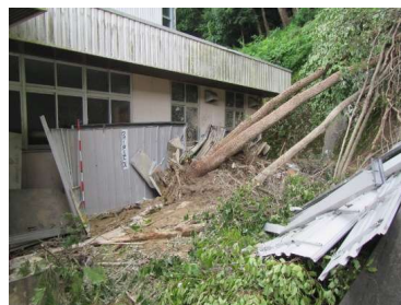
豪雨で被災した 小学校の体育館
