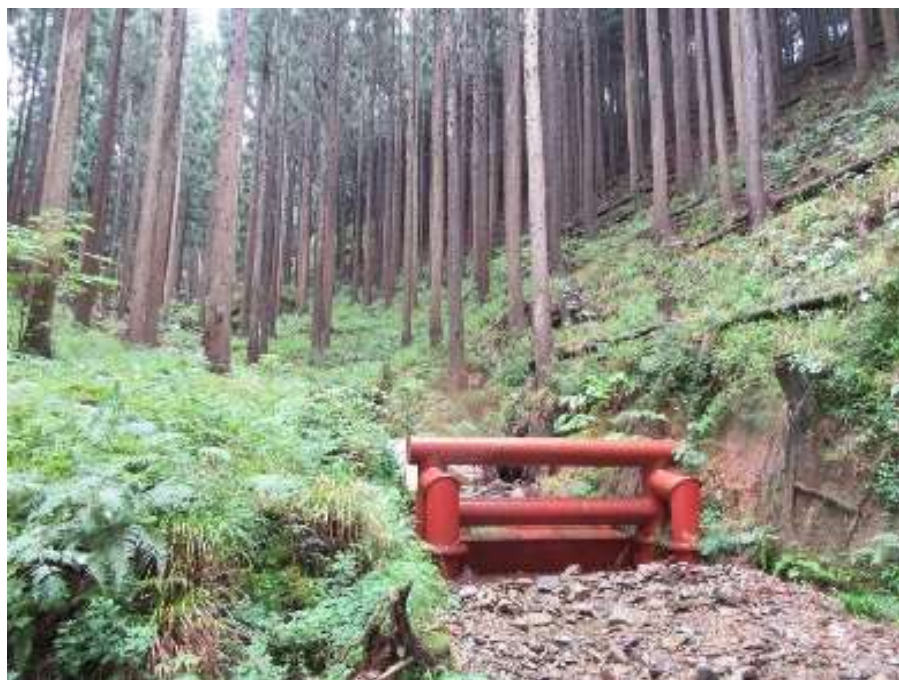
写真 簡易流木止め施設
