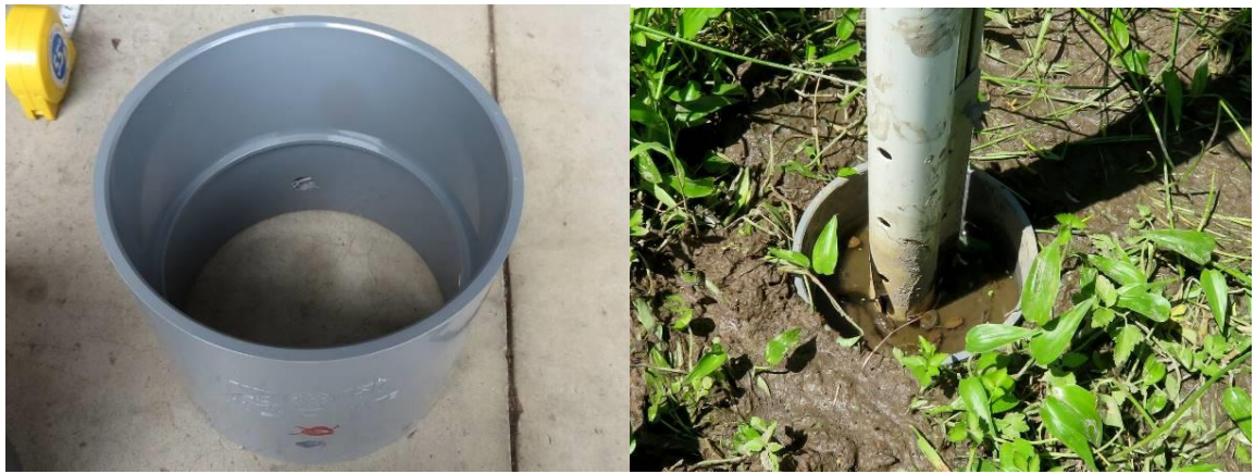
写真1 塩ビ管継ぎ手を利用した水位センサー設置例
