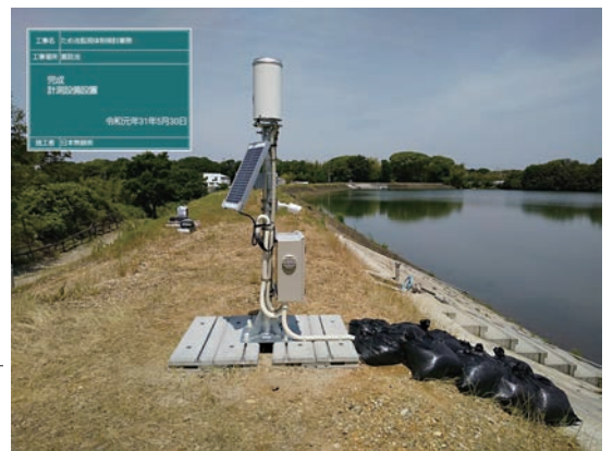
ため池遠隔監視システム
