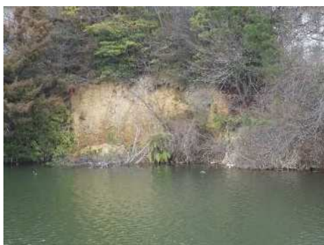
ため池周囲 土砂崩壊
