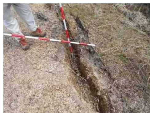
堤頂 ひび割れ
