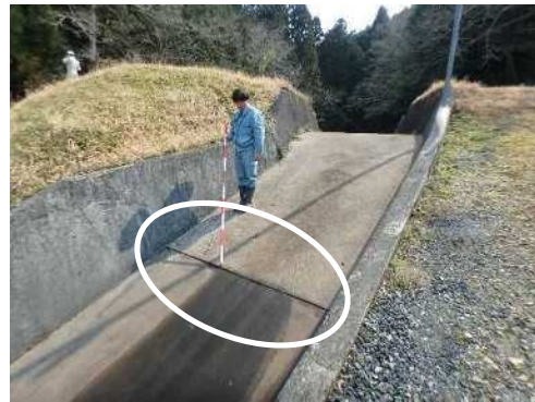
放水路部 漏水
