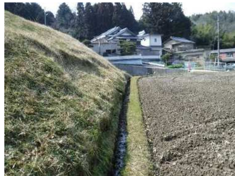
後法 はらみだし及び陥没
