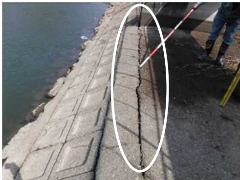
洪水吐流入部 ひび割れ
