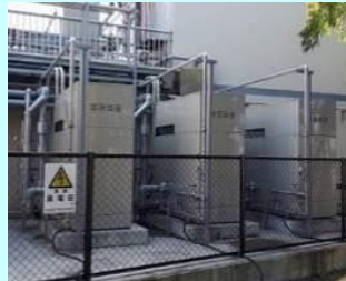
発電機 (25kW×3台)
