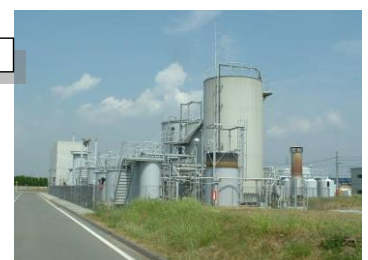
嫌気性排水処理設備
