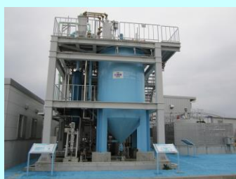
リン回収施設
