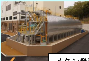
メタン発酵槽 (1,000m 3 )
