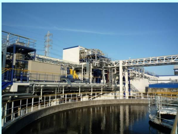
メタン発酵施設
