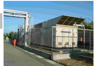
発電施設 (ガスエンジン)
