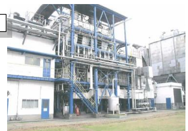
蒸気ボイラー施設
