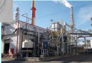
汚泥乾燥燃料と汚泥乾燥施設
