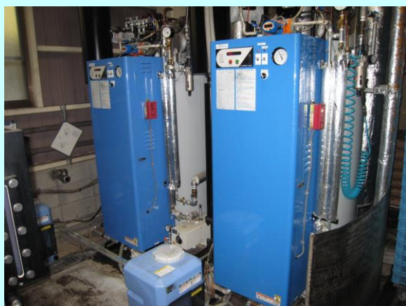
廃油ボイラー
