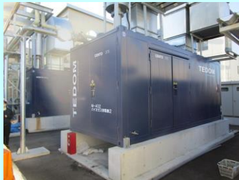
発電機 (360kW×2台)
