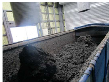
遠心脱水機による固液分離処理
