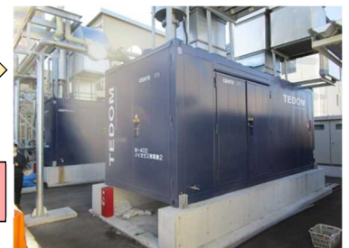
360kW 出力の発電機 2 台で発電 FIT による売電
