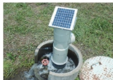
遠隔操作型自動給水栓（たつの市）
