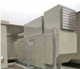
災害等に備えた非常用電源の整備 (令和元年度 神戸市西部市場)
