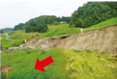
地すべり発生状況(三木市)
