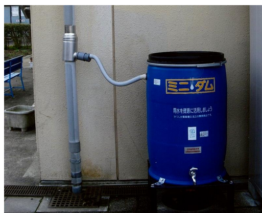
雨水貯留タンク
