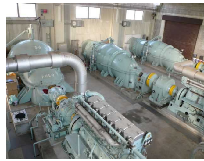
旧排水機場 内部 (横軸斜流ポンプ)
