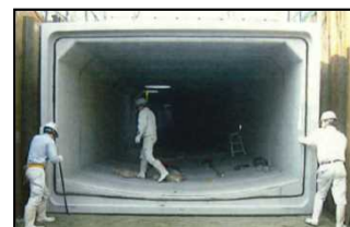
貯留槽[加古川市] ※下水管渠の負担軽減、浸水被害軽減のため、道路下に貯留槽を設置
