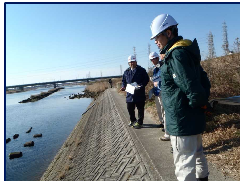
加古川右岸2.6k付近 洗掘
