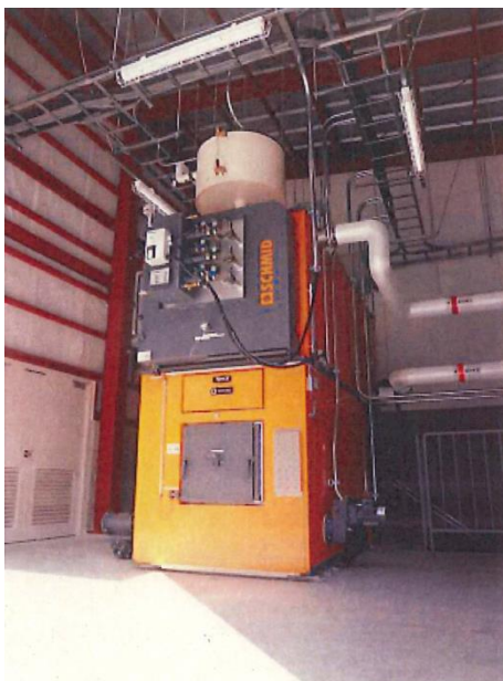
チップボイラー
