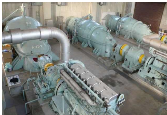
旧排水機場 内部（横軸斜流ポンプ）
