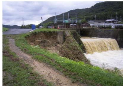
菖蒲池下流の出水状況
