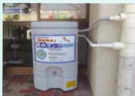
庁舎等に設置した雨水タンク
