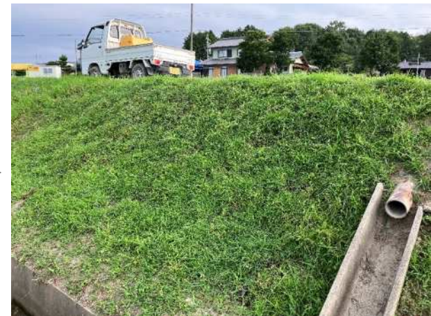
(R5.7.29撮影) ランナーが法面を覆いつくす
