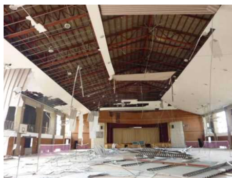
天井崩落事例 (独)建築研究所調査報告資料より
