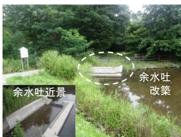
(甲山森林公園) 甲山なかよし池を活用した 雨水貯留
