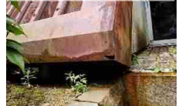
金属屋根の劣化
