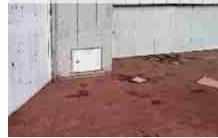
ステージ床面の劣化
