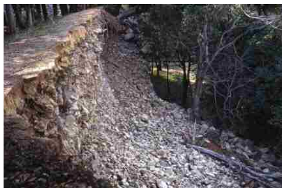
図4-18 震災で崩れた二ノ丸の北辺石垣
