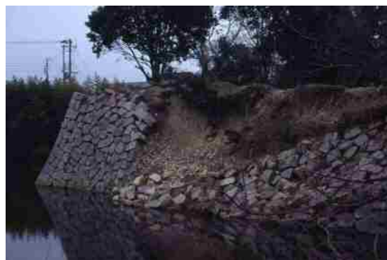
図4-19 震災で崩れた薬研堀石垣
