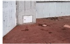
ステージ床面の劣化
