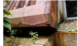
金属屋根の劣化
