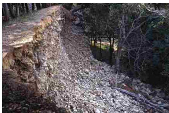
図4-18 震災で崩れた二ノ丸の北辺石垣
