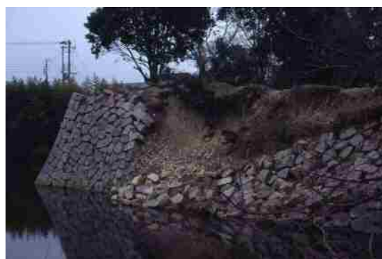
図4-19 震災で崩れた薬研堀石垣
