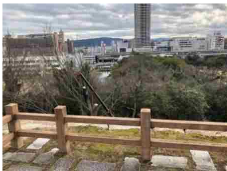
図 5-10 高さが不足する二ノ丸の柵
