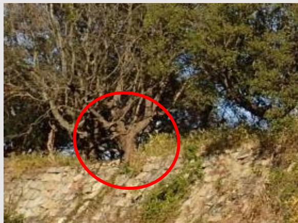
【本丸西】（2021年12月） 樹木の生長や、地震・台風等による倒木で、石垣を壊す恐れがある。
