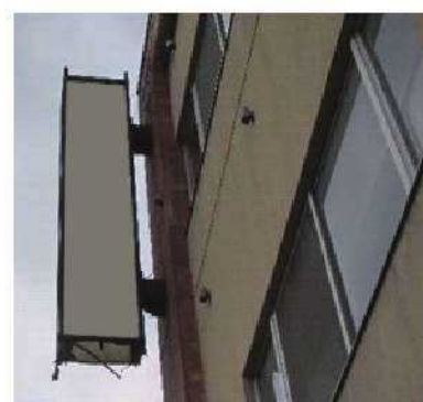
腐食を放置し、底部に穴が空いた例
