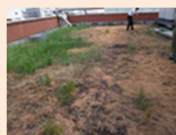
維持管理不足での枯損
