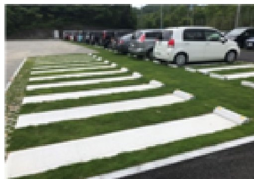
<整備後>コンクリートブロックで補強した芝生化駐車場（福崎町）
