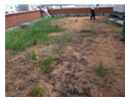
維持管理不足で枯損
