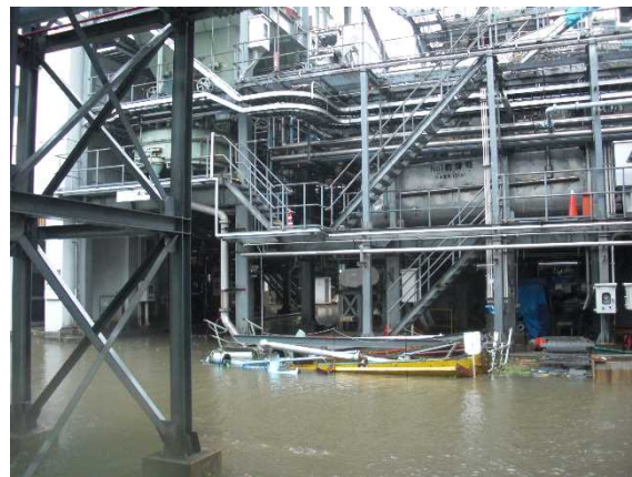
浸水被害状況(兵庫東流域下水汚泥広域処理場)
