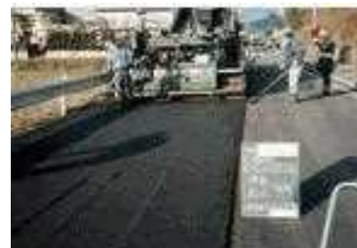
溶融スラグを活用したアスファルト舗装 （兵庫西流域下水汚泥広域処理場）
