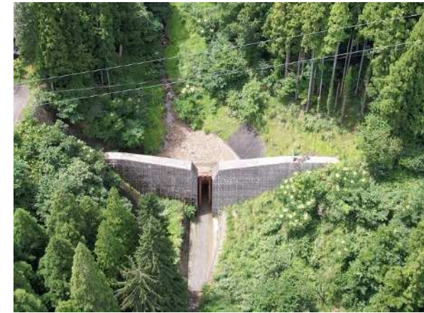
土石流発生直後
