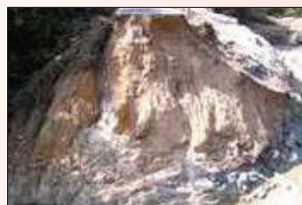
土石流により 道路が崩落
